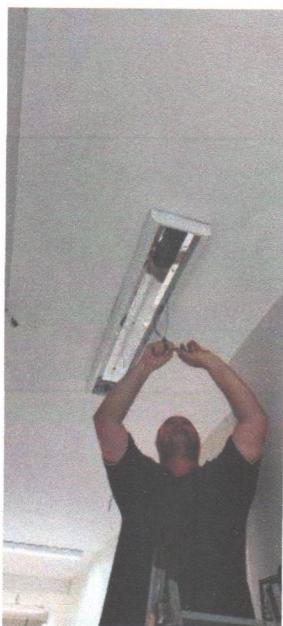
Troca de lâmpada corredor administração
