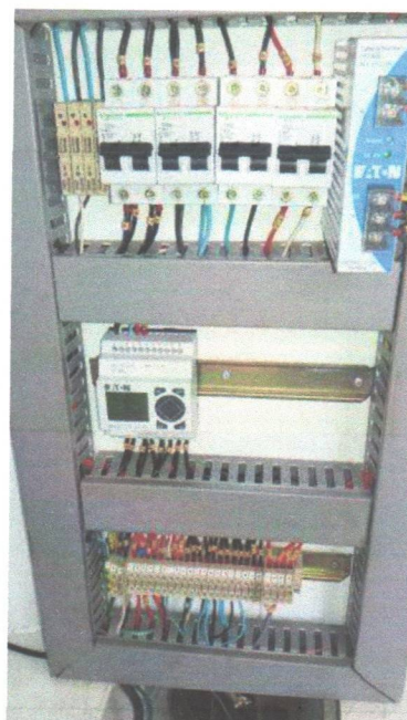
Ajuste fonte 24v painel casa de maquina
