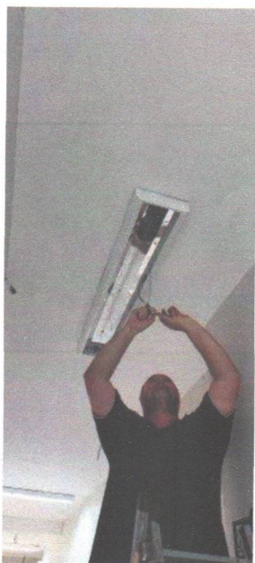
Troca de lâmpada corredor administração
