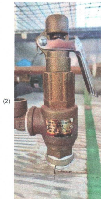
Valvula velha apresentou pequeno vazamento
