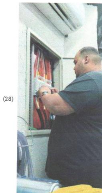
Revisão chave seca autoclave usina e bomba de incêndio
