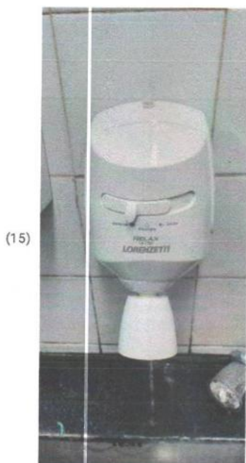
Chuveiro banheiro recém-nascido
