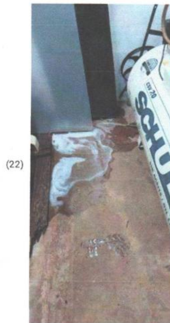
Drenando reservatorio ar comprimido Medicinal
