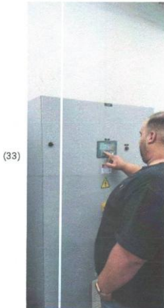
Ajustes e test do CLP Gerador (USCA) unidade de supervisão de corrente alternada
