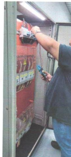
Test painel de distribuição de circuitos comuns
