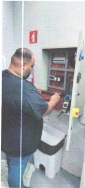
Test painel de iluminação de emergência sala gerador
