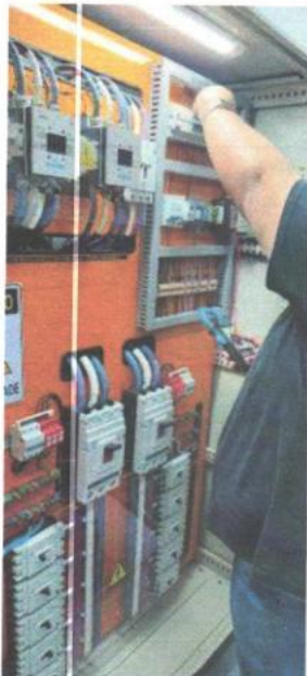
Test painel de distribuição de circuitos específicos
