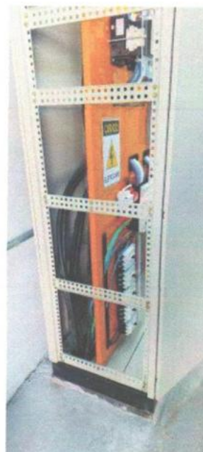
Revisão cabos de potencia painel
