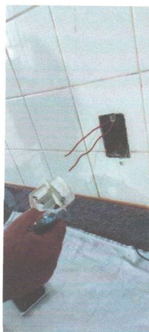
Tomada quebrada sala de expurgo
