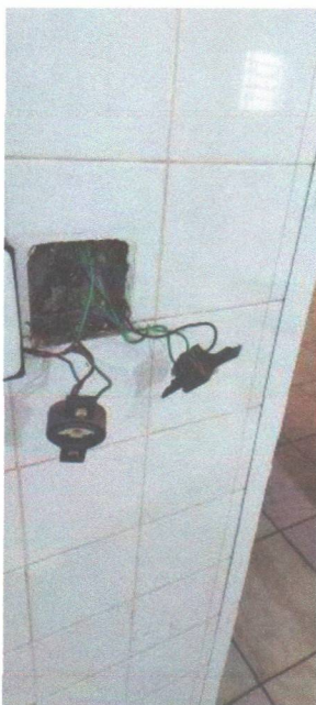
Tomadas e interruptor quebrados sala de expurgo
