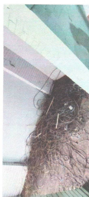
Cabos velhos sem uso retirado do forro onde esta ocorrendo reforma
