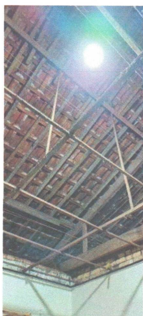
Espeço limpo sem cabos velhos
