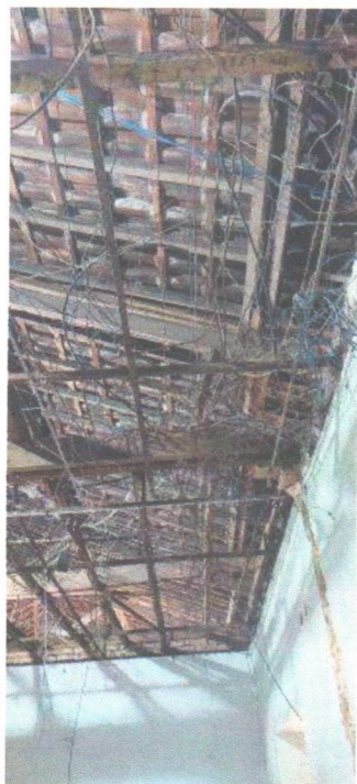
Forro com grande contidade de cabos sem uso
